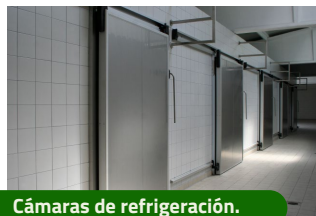
Cámaras de refrigeración.
